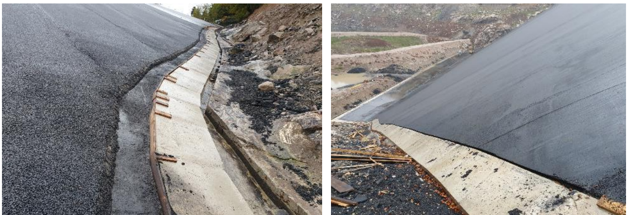
Figure 9 : Vue de la poutre de butée sur Kruth, avant et après mise en œuvre de la couche d'étanchéité supérieure
