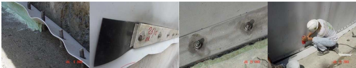
Figure 19 : Fixation étanche (de gauche à droite : résine d'assise, garniture caoutchouc, fer plats inox, mise en œuvre des ancrages) – source : CARPI
