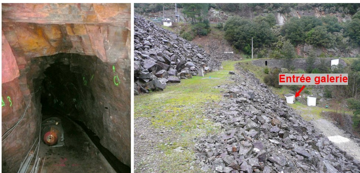
Figure 3-12 : Galerie de drainage appui rive gauche (risberme 234 m NGF)
