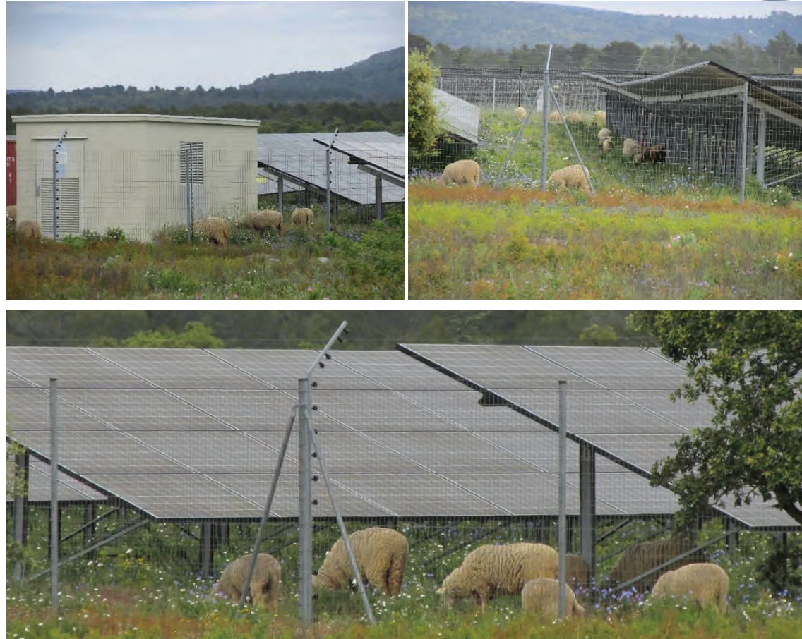
Exemple de pâturage ovin actuellement mis en place au cœur d'un parc photovoltaïque
