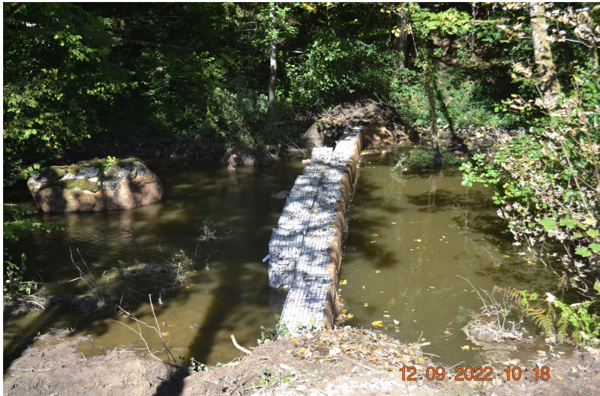
Figure 9 : Dispositif de barrage filtrant mis en œuvre dans le cadre de la vidange du barrage des Settons (maîtrise d'œuvre ISL-EGIS)
