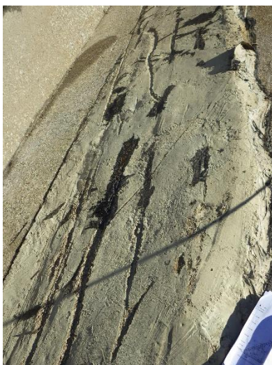
Photo 65 : Défaut n°11 – Dégâts de déboisement constatés en 2013
