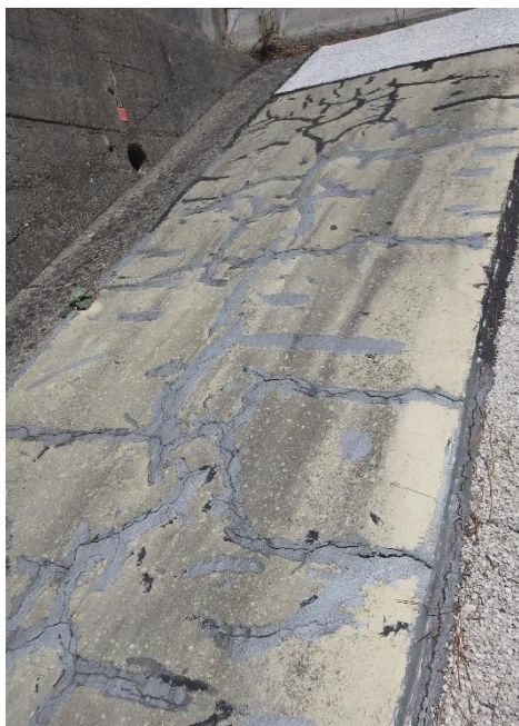
Photo 50 : Fissuration des doucines
