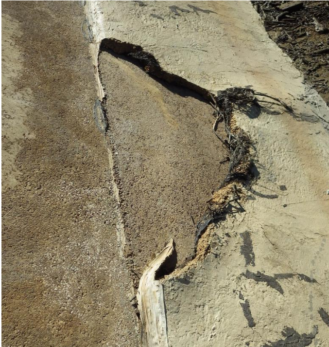
Photo 68 : Défaut n°26 – Arrachement du couvre-joint
