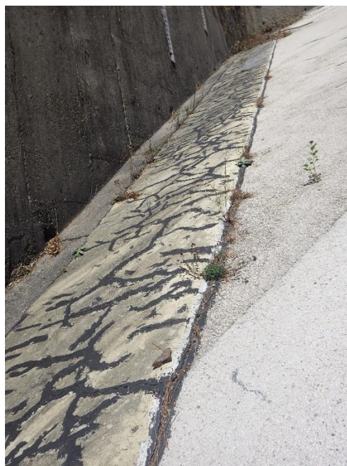
Photo 51 : Fissuration des doucines
