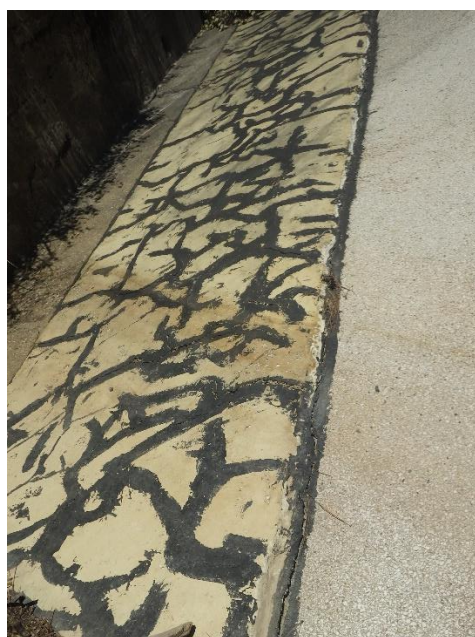
Photo 52 : Fissuration des doucines
