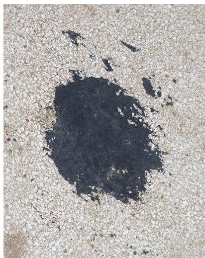
Photo 58 : Défaut n°31 – Impact réparé sur la bande n°9
