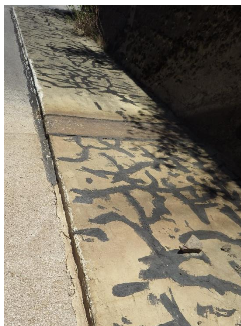
Photo 53 : Fissuration des doucines
