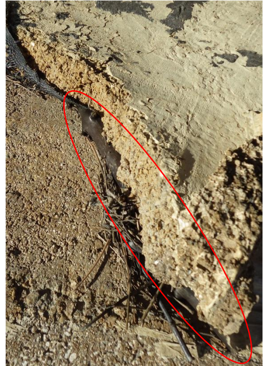
Photo 69 : Défaut n°26 – Présence d'un bois au droit de la partie arrachée du couvre-joint
