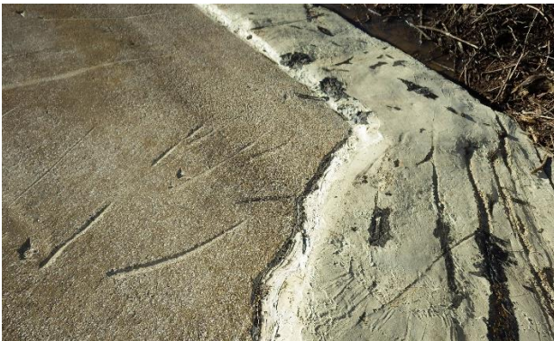
Photo 63 : Défaut n°10 – Dégâts de déboisement constatés en 2013
