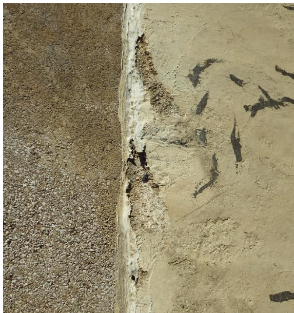
Photo 67 : Défaut n°27 – Dégâts au niveau de la plinthe
