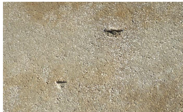
Photo 66 : Défaut n°12 – Traces de dents de pelle mécanique sur la bande n°18
