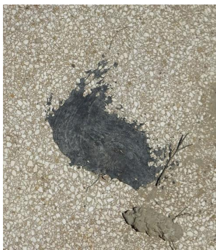
Photo 57 : Défaut n°30 – Impact réparé sur la bande n°9
