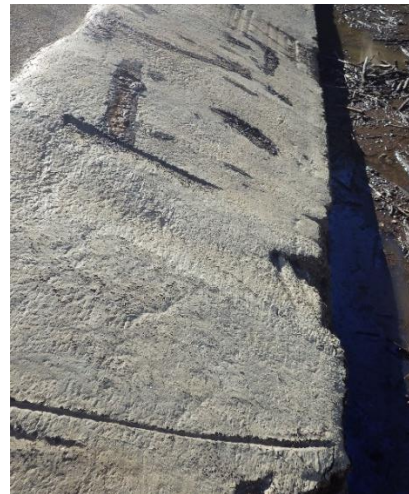
Photo 64 : Défaut n°11 – Dégâts de déboisement constatés en 2013
