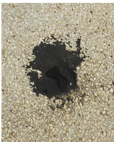
Photo 59 : Défaut n°32 – Impact réparé sur la bande n°9
