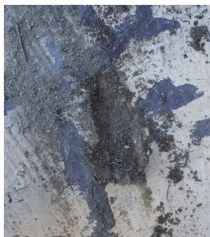
Photo 60 : Défaut n°35 – Impact sur la doucine RD
