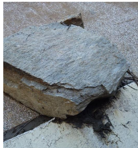
Photo 56 : Défaut n°29 – Rocher sur le parement
