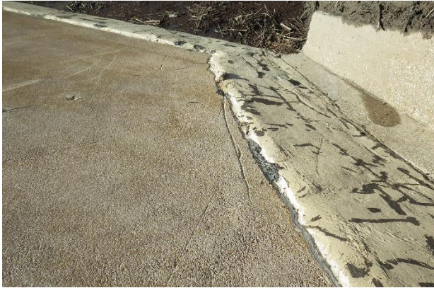
Photo 61 : Défaut n°8 – Dégâts de déboisement constatés en 2013
