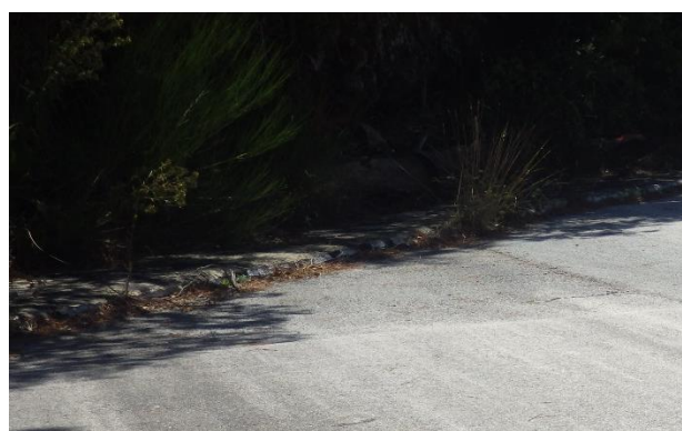
Photo 30 : Défaut n°48 – Différences de tassement sur la bande n°1
