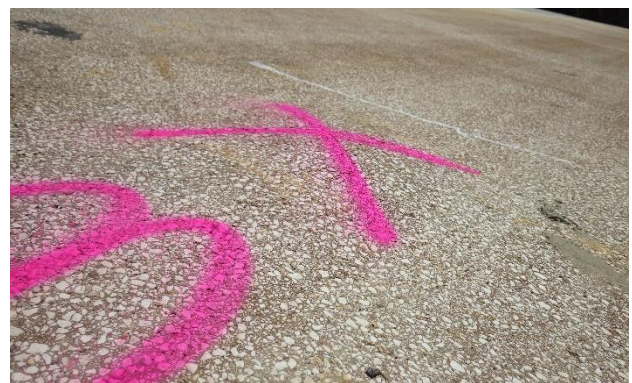
Photo 4 : Défaut n°16 – Cloque sur bande n°20 (vue de profil)
