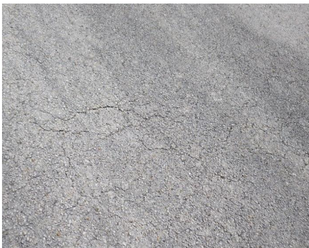
Photo 13 : Défaut n°18 – Fissures sur bande n°21 (profondeur : 1.5cm)
