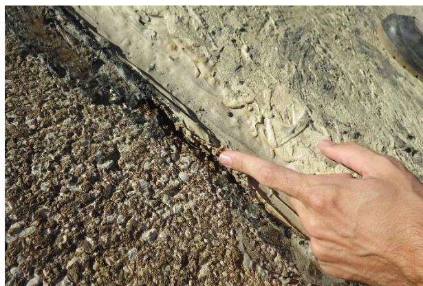
Photo 36 : Défaut n°14 – Décollement au niveau de la plinthe sur la bande n°21 (15cm de long)
