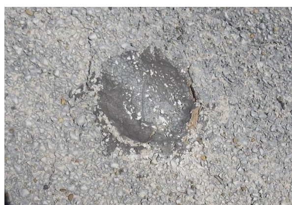
Photo 24 : Défaut n°46 – Forage rebouché sur la bande n°3 (sans évolution par rapport à 2013)
