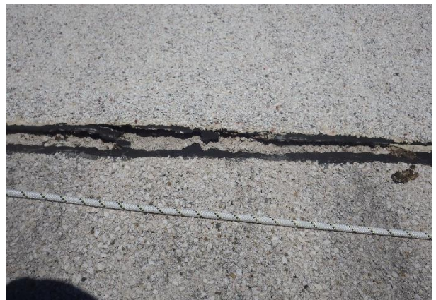
Photo 45 : Décollement de la surépaisseur
