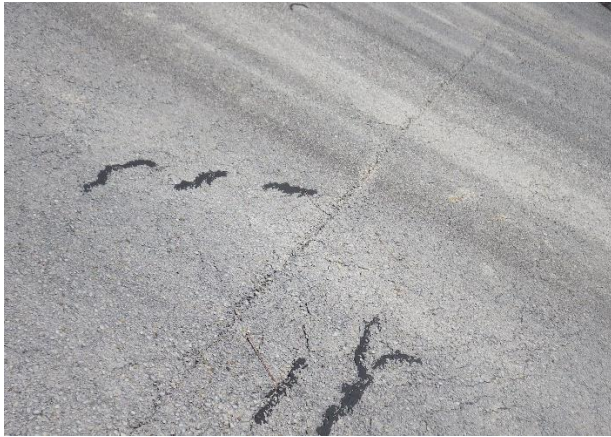
Photo 10 : Défaut n°40 – Fissure en RD sur la bande n°5
