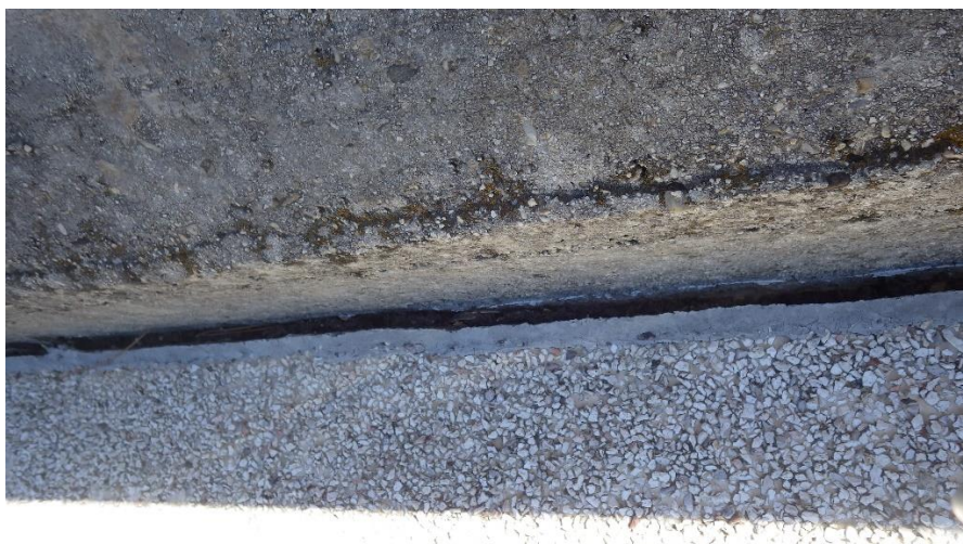
Photo 43 : Décollement de l'étanchéité entre le mur de couronnement et le masque en partie supérieure
