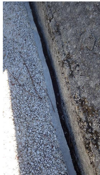
Photo 42 : Décollement de l'étanchéité entre le mur de couronnement et le masque en partie supérieure
