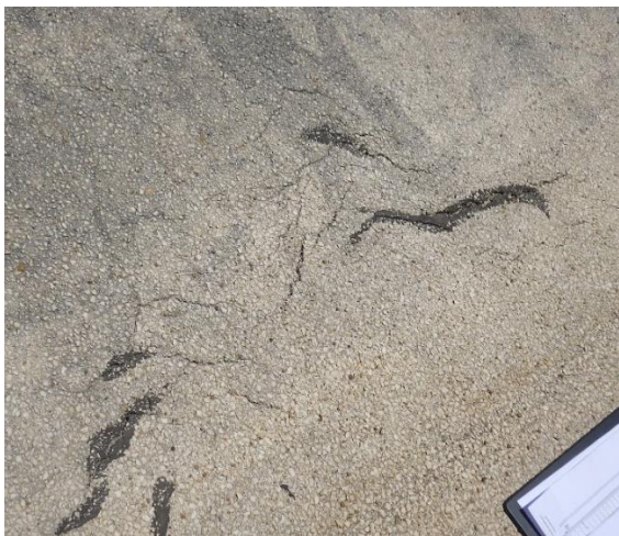
Photo 15 : Défaut n°33 – Fissures sur bande n°10 (profondeur : 2cm)
