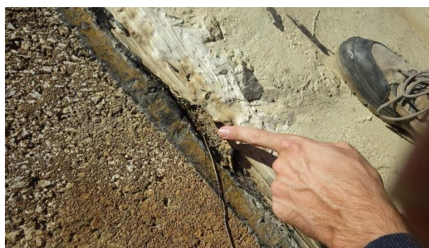
Photo 38 : Défaut n°24 – Décollement au niveau de la plinthe sur la bande n°16 (15cm de long)
