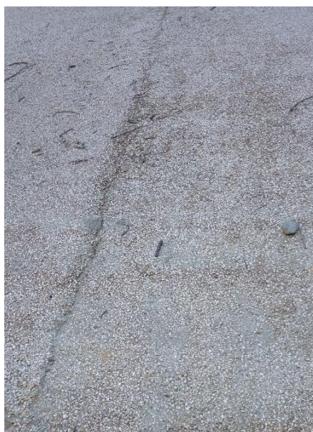
Photo 17 : Défaut n°34 – Fluage du matériau bitumineux sur la bande n°7
