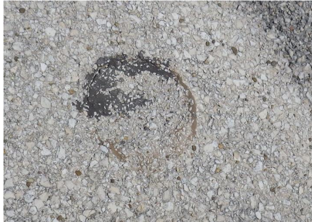
Photo 25 : Défaut n°45 – Forage rebouché sur la bande n°4 (sans évolution par rapport à 2013)
