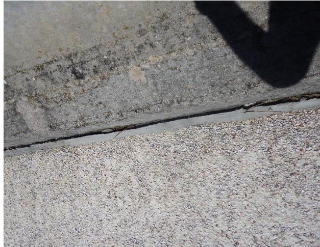
Photo 40 : Défaut n°51 – Décollement de l'étanchéité entre le mur de couronnement et le masque en partie supérieure
