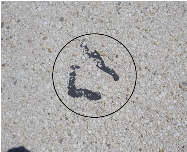
Photo 1 : Défaut n°6 – Cloque sur la bande n°27
