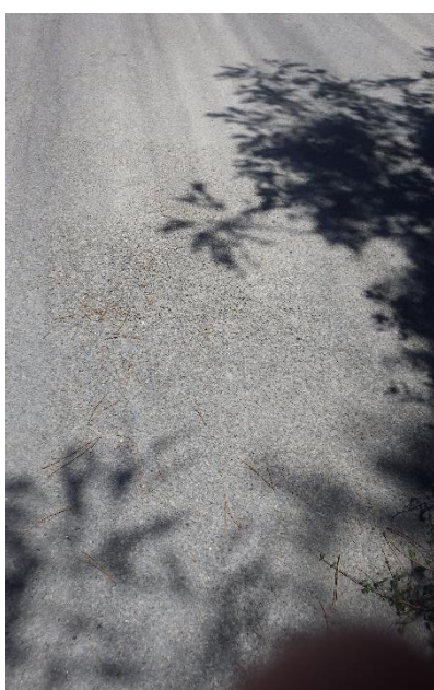
Photo 29 : Défaut n°47 – Différences de tassement sur la bande n°2
