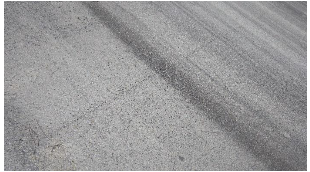
Photo 11 : Défaut n°42 – Fissure en RD sur la bande n°5
