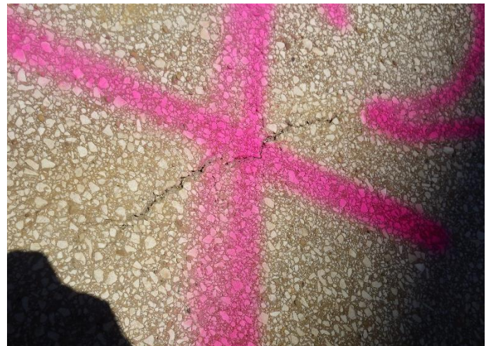
Photo 14 : Défaut n°25 – Fissures sur bande n°14 (profondeur : 1.5cm)
