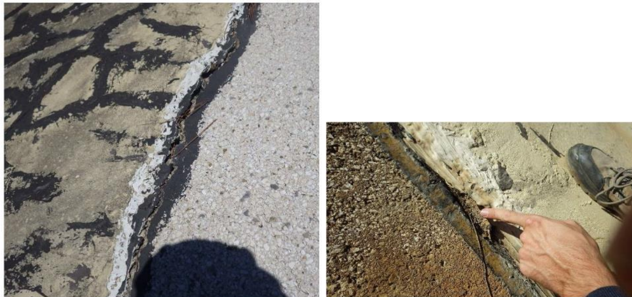
Figure 22 : Défauts au niveau du couvre-joint
