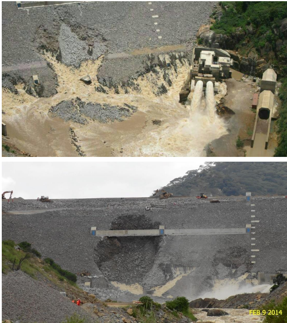
Figure 58 : Déchaussement du pied aval du barrage de Tokwé-Mukorsi (2014)
