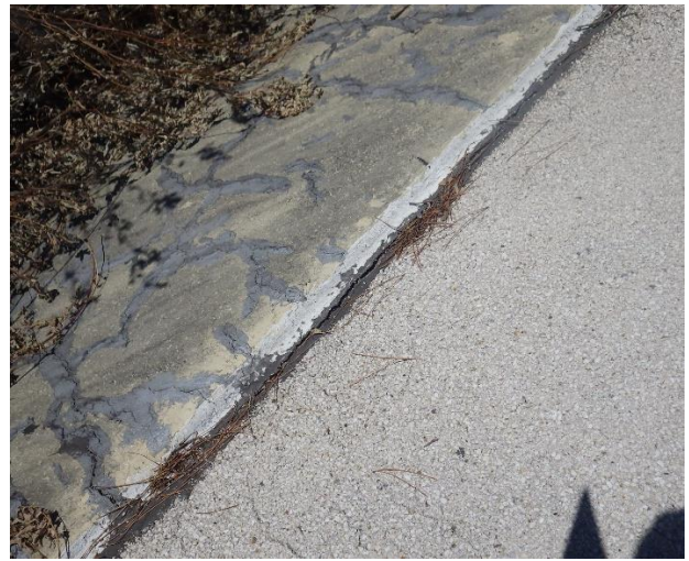
Photo 32 : Défaut n°2 – Décollement au niveau de la doucine RG
