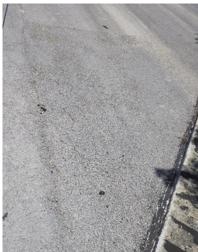
Photo 27 : Défaut n°39 – Différences de tassement sur la bande n°5
