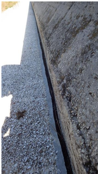
Photo 41 : Décollement de l'étanchéité entre le mur de couronnement et le masque en partie supérieure
