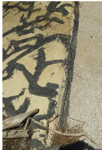
Photo 34 : Défaut n°7 – Décollement au niveau de la doucine RG
