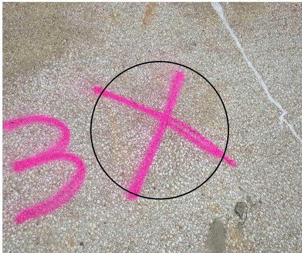
Photo 3 : Défaut n°16 – Cloque sur bande n°20
