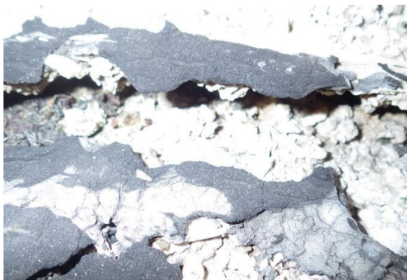
Photo 46 : Décollement de la surépaisseur
