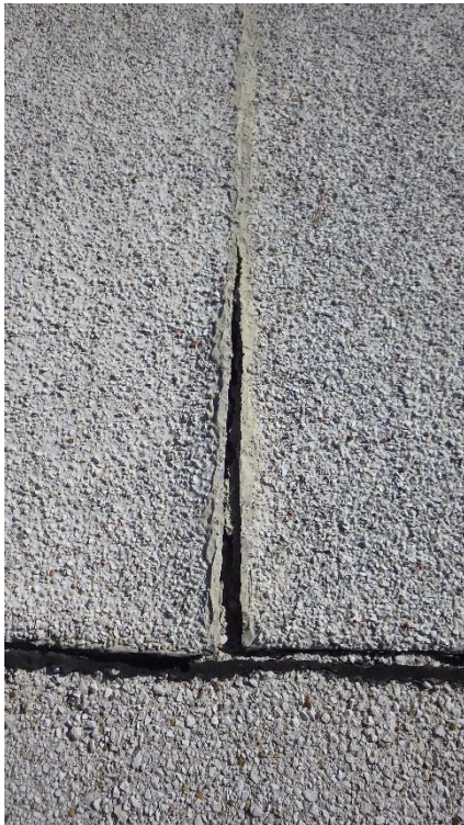
Photo 48 : Défaut n°53 – Ouverture de l'étanchéité en partie supérieure, dans le sens vertical, sur la bande n°14
