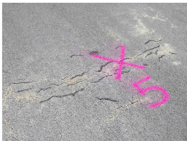
Photo 8 : Défaut n°19 – Réseau de fissures sur bande n°20
