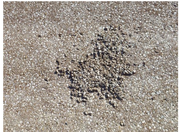
Photo 19 : Défaut n°23 – Forage rebouché sur la bande n°16 (sans évolution par rapport à 2013)
