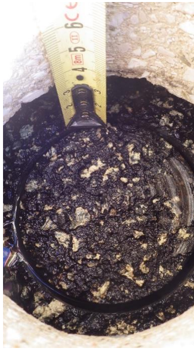
Photo 5 : Défaut n°16 – Cloque sur bande n°20 (vue dans le trou de carottage)
