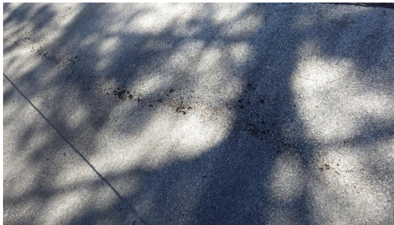
Photo 12 : Défaut n°50 – Fissure en RD sur la bande n°1
