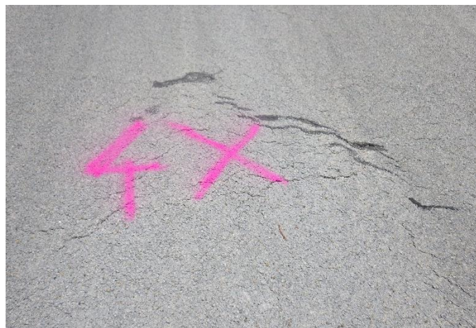
Photo 16 : Défaut n°38 – Fissures sur bande n°7 (profondeur : 2cm)
