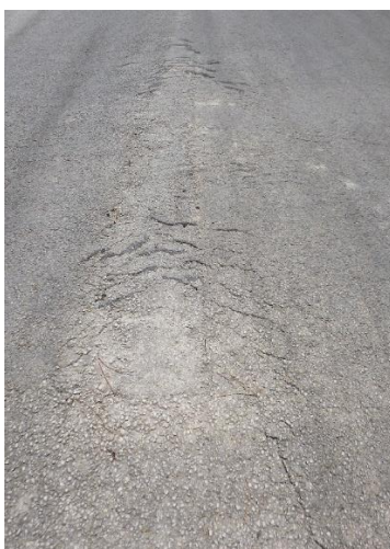
Photo 9 : Défaut n°36 – Fissure en RD entre les bandes n°7 et 8
