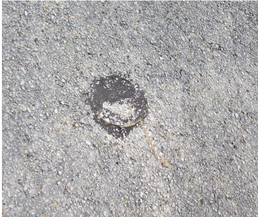
Photo 18 : Défaut n° 17 – Forage rebouché sur la bande n°21 (sans évolution par rapport à 2013)
