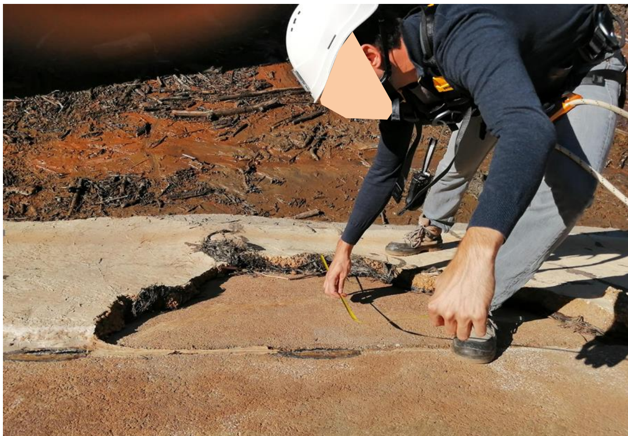
Figure 23 : Désordre découvert lors de l'inspection en 2020
