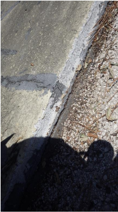
Photo 31 : Défaut n°1 – Décollement au niveau de la doucine RG
