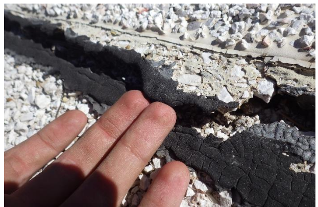
Photo 47 : Décollement de la surépaisseur
