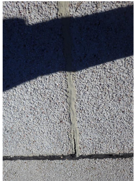
Photo 49 : Défaut n°54 – Ouverture de l'étanchéité en partie supérieure, dans le sens vertical, sur la bande n°26
