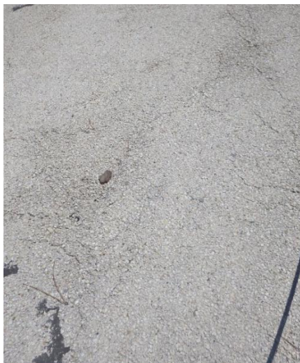
Photo 6 : Défaut n°3 – Zone de fissures en RG sur bande n°30
