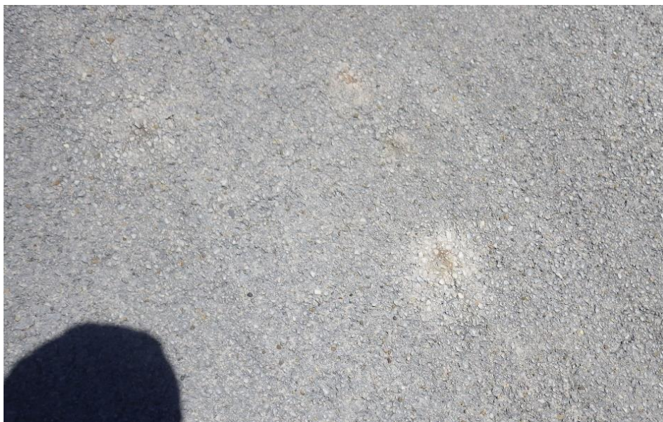
Photo 26 : Défaut n°37 – Petites ouvertures dans le masque sur la bande n°7
