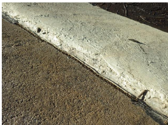
Photo 35 : Défaut n°13 – Décollement au niveau de la plinthe sur la bande n°22 (1m de long)
