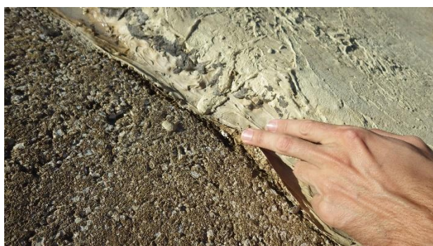
Photo 37 : Défaut n°15 – Décollement au niveau de la plinthe sur la bande n°20 (30cm de long)
