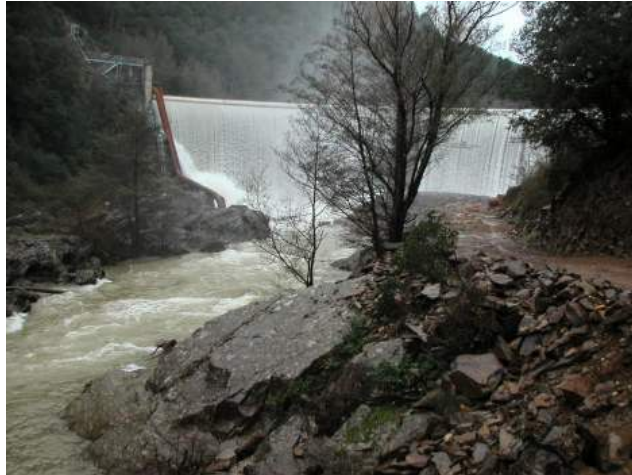
Photographie 18 : Surverse du barrage lors des travaux de 2002 / 2003
