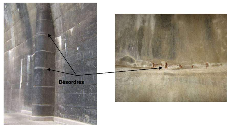
Figure 21 : Désordres observés sur la cheminée aval avec des vues de l'extérieur et de l'intérieur
