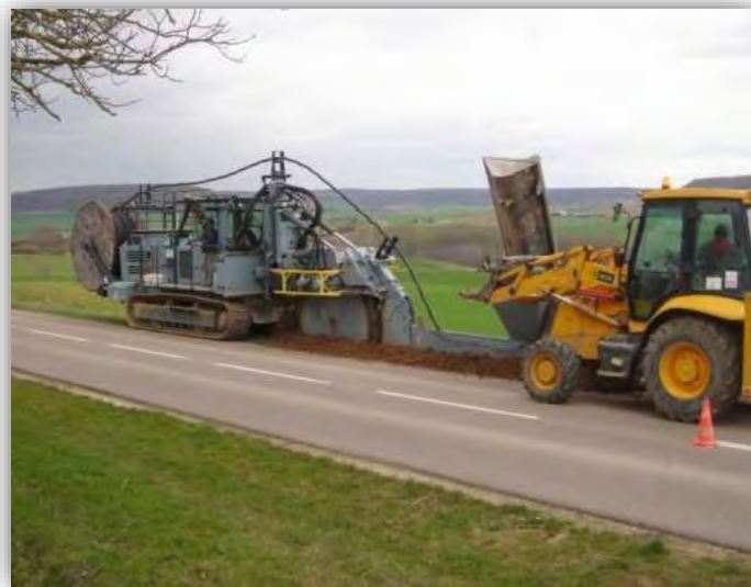
Réalisation d'une tranchée d'enfouissement des câbles de raccordement au réseau public de
