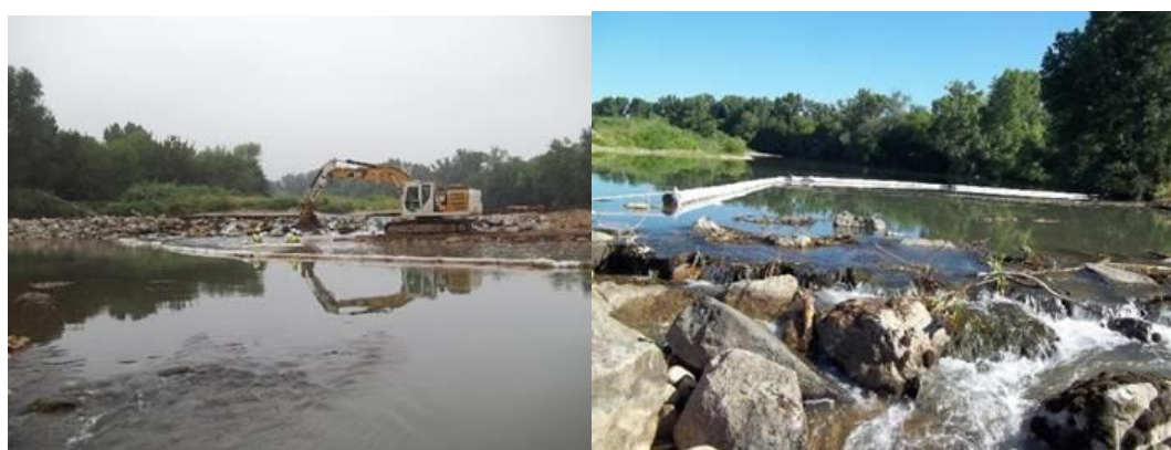
Illustration de dispositif permettant de limiter les départs des MES (source : Oteis)
