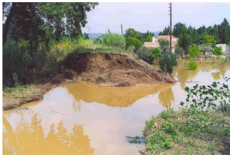
Figure 11 : Brèche sur le tronçon Sud de la digue d'Aramon (DDAF, 2002)
