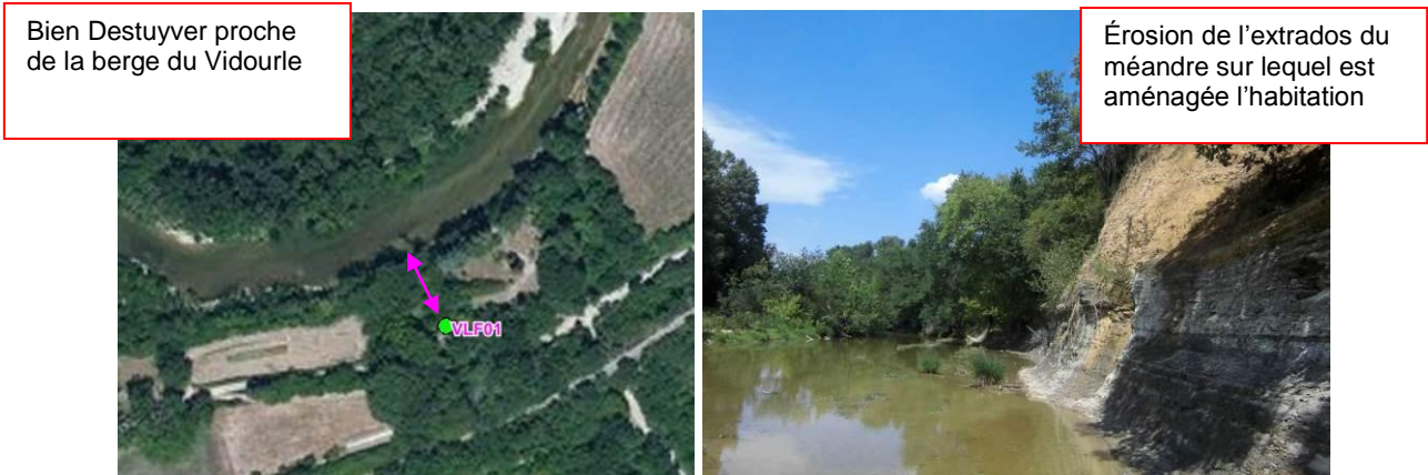
Figure 22 : Vue de l'érosion de la berge sur laquelle est implantée le bien Destuyver (Safege, 2015)
