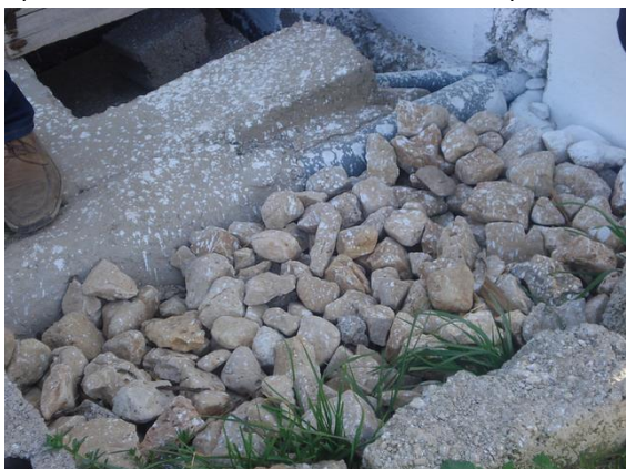
Photographie 5 : un puits d'infiltration
